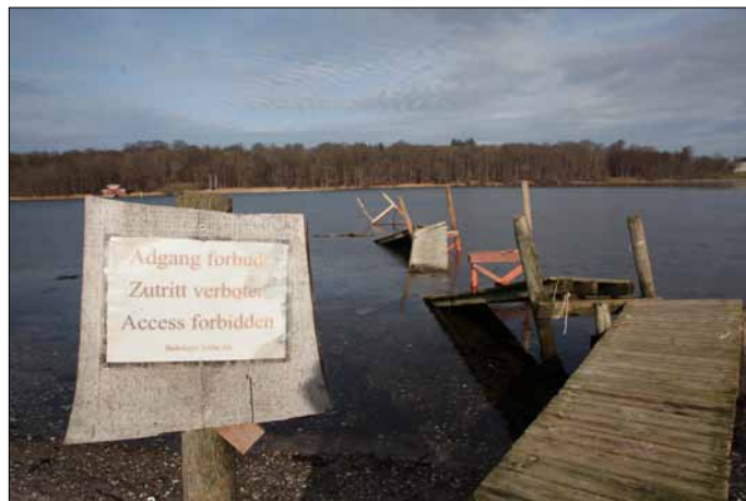
Broen har virkelig taget skade af isen og blæsten.
